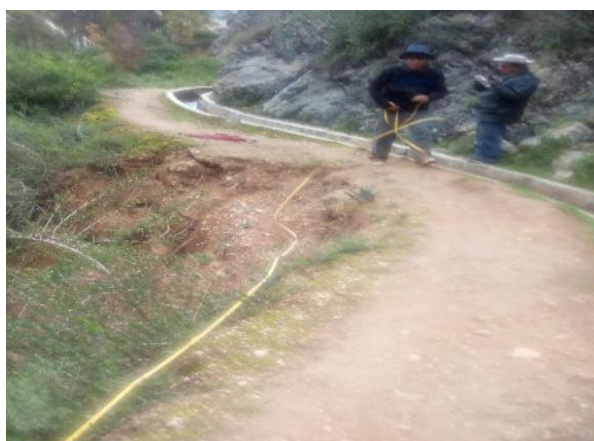
Fotografía 01. Se observa la plataforma del canal en peligro de deslizamiento (Trabajos de campo para perfil)
