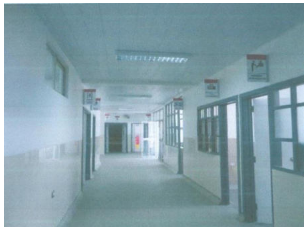
CONTRATACION DE SERVICIO DE MANTENIMIENTO DEL HOSPITAL VICTOR RAMOS GUARDIA DE HUARAZ – ANCASH (OBRA EN EJECUCION - 60.18%)
