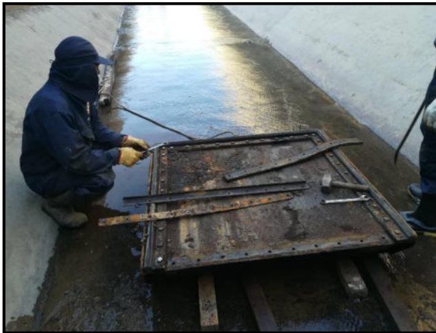
Desmontaje de la compuerta de purga N° 1 del Desarenador la Víbora, para efectuar trabajos de mantenimiento correctivos.
