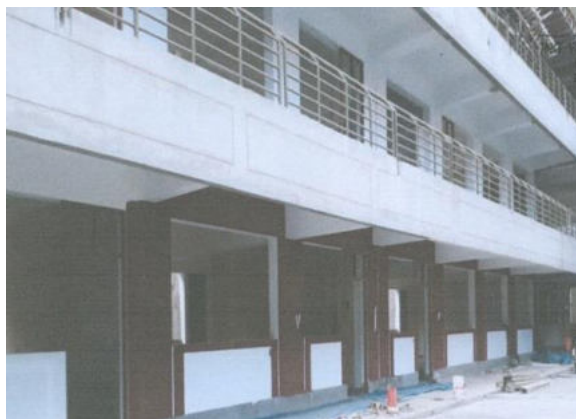
MEJORAMIENTO DE LOS SERVICIOS EDUCATIVOS DE I.E. N° 86344 JAVIER HERAUD PEREZ, ACOCHACA, PROVINCIA DE ASUNCION, ANCASH (OBRA EN EJECUCION - 85.83%)
