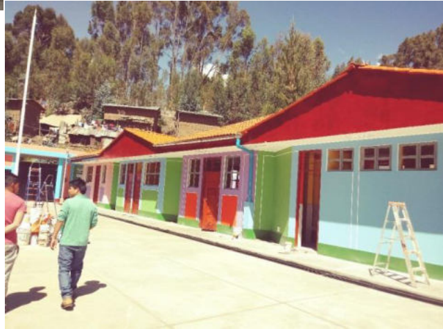
AMPLIACION Y MEJORAMIENTO DE LOS SERVICIOS DE EDUCACIÓN INICIAL DE LA INSTITUCIÓN EDUCATIVA N° 530 BARRIO CHINLLILLIN, DISTRITO DE HUALLANCA - BOLOGNESI – ANCASH (OBRA CULMINADA)
