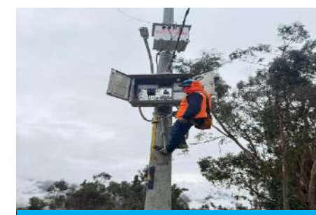
MEJORAMIENTO Y AMPLIACION DE LAS REDES PRIMARIAS 22.9 KV Y SECUNDARIAS 380/220 EN LA ZONA RURAL Y URBANA DEL DISTRITO DE MIRGAS - PROVINCIA DE ANTONIO RAYMONDI - DEPARTAMENTO DE ANCASH
