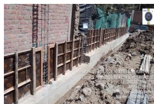
RECONSTRUCCIÓN DEL CENTRO DE SALUD MANCOS I-3, DISTRITO DE MANCOS, PROVINCIA DE YUNGAY, REGIÓN ANCASH
